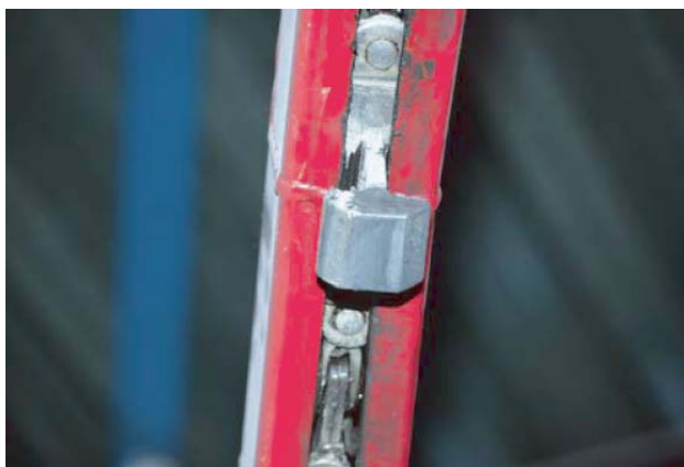
Foto 5 Kedjetransportörerna löper i en tunnel som är uppbyggd av skenor. Dessa är långa, krokiga och ganska grovt konstruerade.
